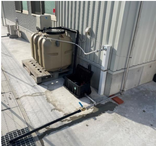
【ポンプ・コントロール部】 電磁弁、ポンプ、制御盤も再利用することが出来ました。
